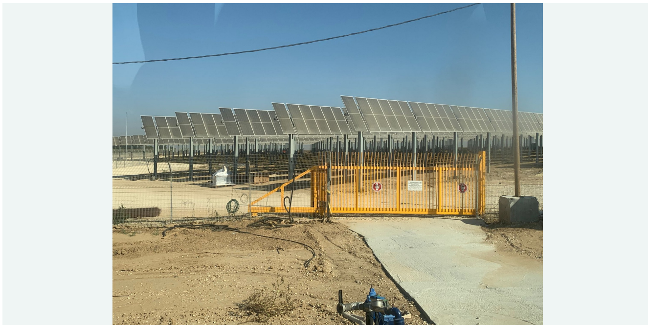
نمایی از تأسیسات و تجهیزات تولیدی در مجموعه بازدیدشده.
